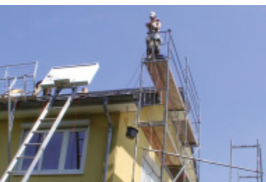
Absturzgefahr an der Annahmestelle der Module neben dem Dachdeckeraufzug
