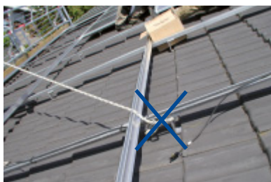
Unsicherer Anschlagpunkt an dem Gestell
