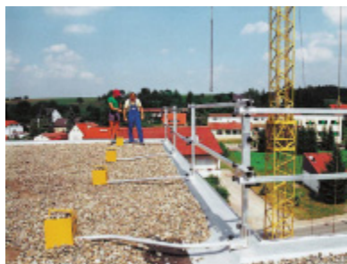
Absturzsicherung auf dem Flachdach
