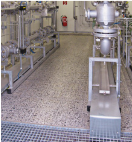
Abbildung 11: Betonwerkstein-Platten in einer GDRM-Anlage
