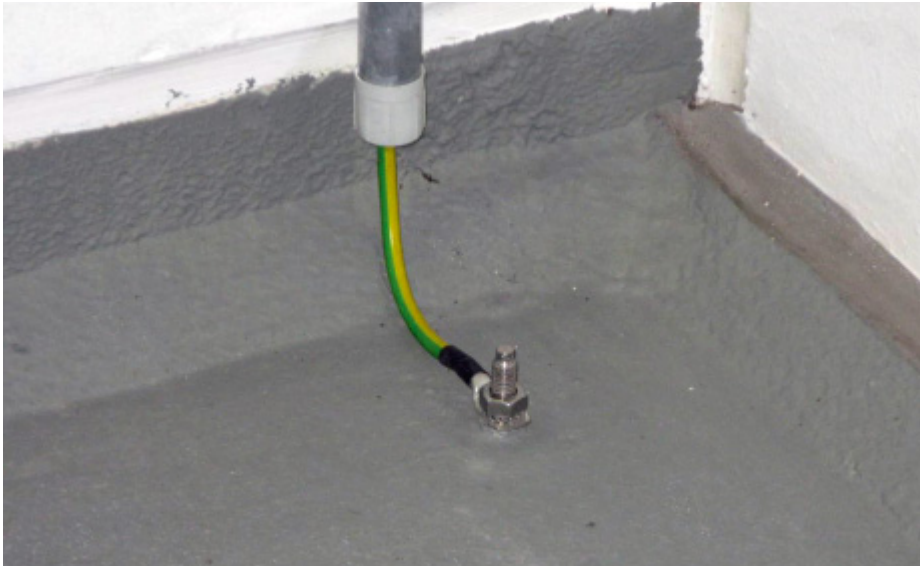
Abbildung 8: Erdungsanschluss ableitfähiger Fußboden
