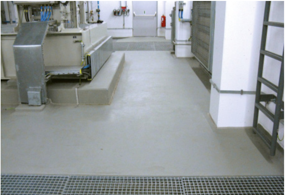
Abbildung 10: Fußboden in einer Gas-Verdichterhalle (WHG-Aufbau, ableitfähig, rutschhemmend)
