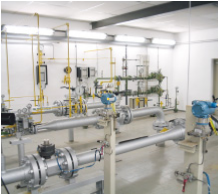
Abbildung 3: Aufstellungsraum einer GDRM-Anlage
