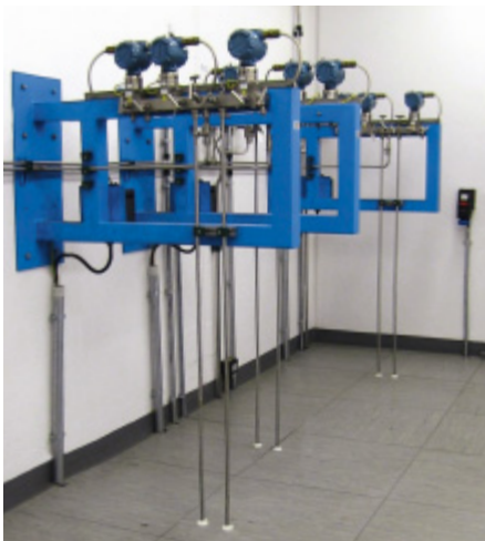
Abbildung 12: Messumformerraum mit aufgeständertem Plattensystem-Fußboden (ableitfähig)
