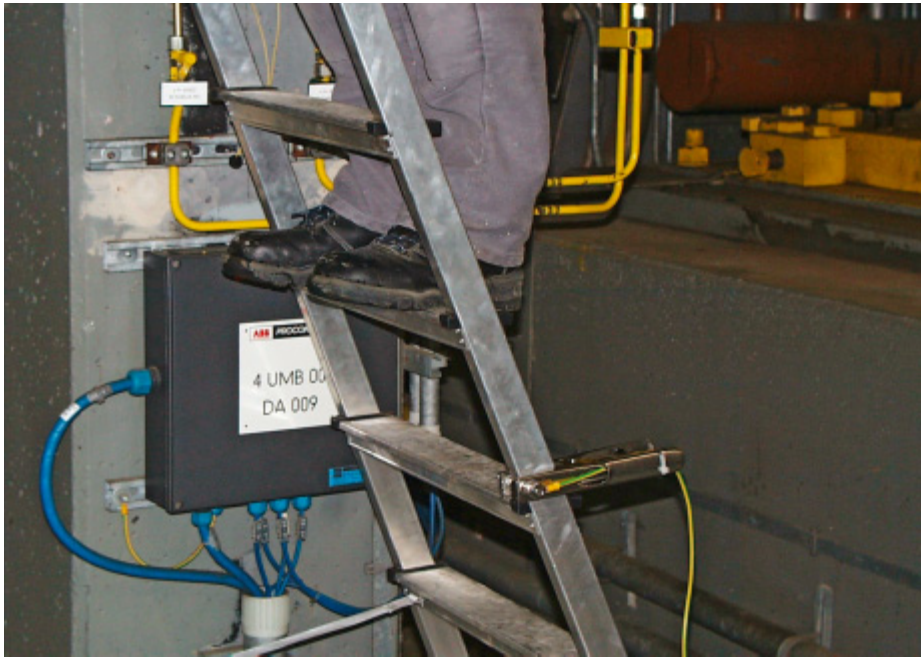
Abbildung 13: Erdung einer mobilen Einrichtung (Stehleiter)
